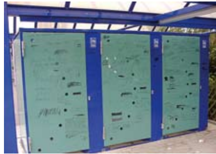
Vandalismus an einer Fahrradabstellanlage
